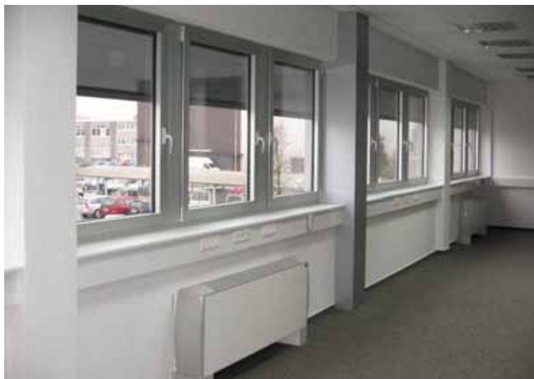
Ogrevanje in hlajenje je izvedeno z ventilatorskimi konvektorji Climmy 4
