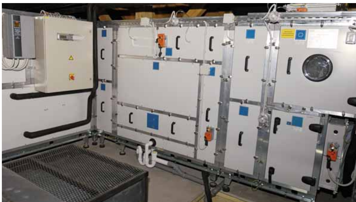
Klimatska naprava z vso avtomatiko in povezavo na CNS
