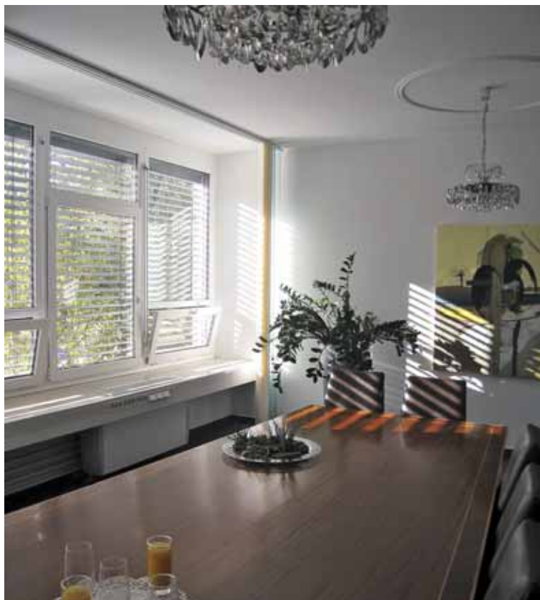
Ventilatorski konvektorji Hidria vgrajeni kot pol-vidna izvedba v sejni sobi in pisarnah
